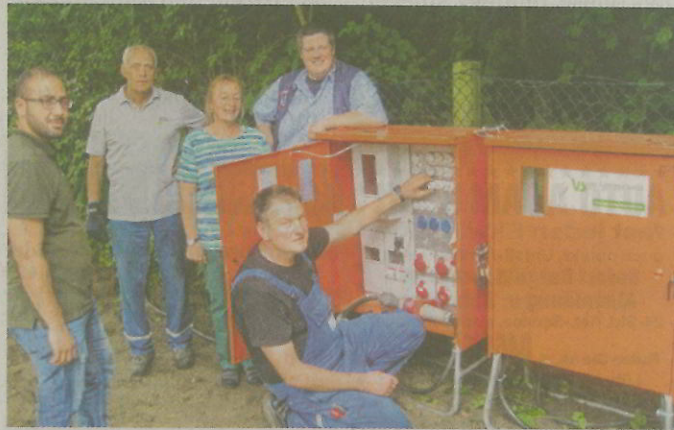
Von links: Praktikant Mouaz Hammoudeh, Flüchtling aus Syrien, und Holger Nestler von den Vereinigten Stadtwerken sowie Ute Ostendorf und Jens Pechel schauen interessiert zu, wie Jan Henning die Funktion des Baustromkastens überprüft. Foto: Klein
