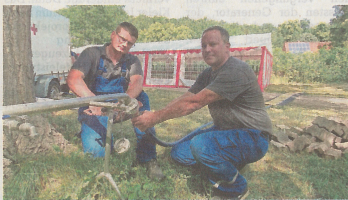
Meik Saedler (r.) und Lucas Jahns von den Vereinigten Stadtwerken installieren den Wasseranschluss auf dem Gelände der Zeltstadt Tillhausen.
